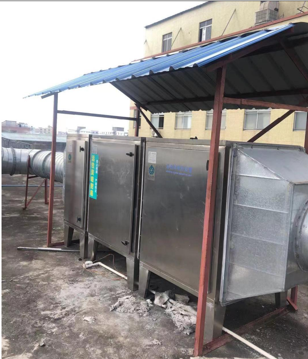
干式过滤器+两级活性炭吸附装置
